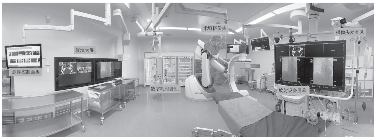
注：悬浮控制面版功能为实现视频分屏、录制、手术会议、文档管理等功能。嵌墙大屏主要显示手术室视频、支持线上会议、展示术前信息。数字耗材管理主要是实时统计柜内耗材型号数量。放射设备屏幕支持画面实时切换各种信息。摄像头麦克风采集术者影像，支持实时沟通
